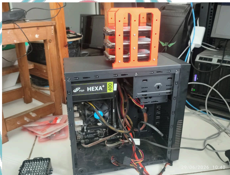
Gambar 4.4 Penempatan Hardware di Ruang Server
