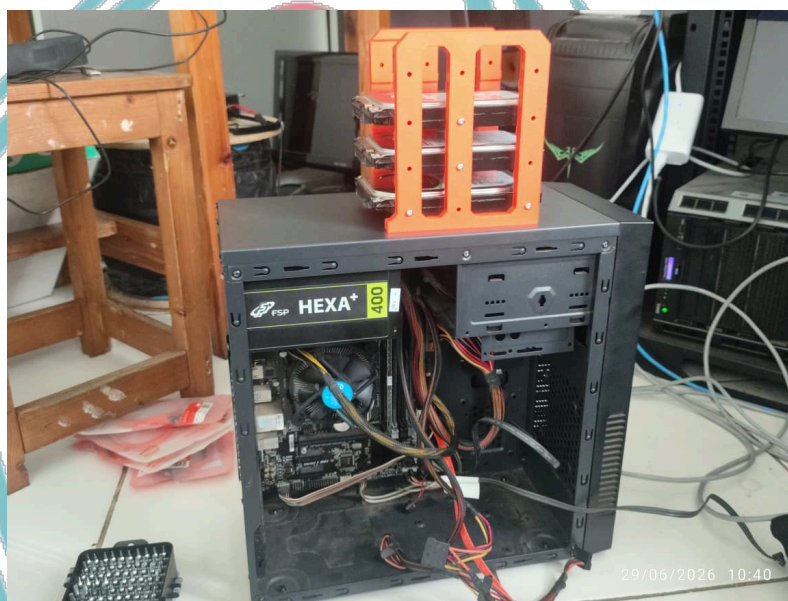
Gambar 4.4 Penempatan Hardware di Ruang Server
