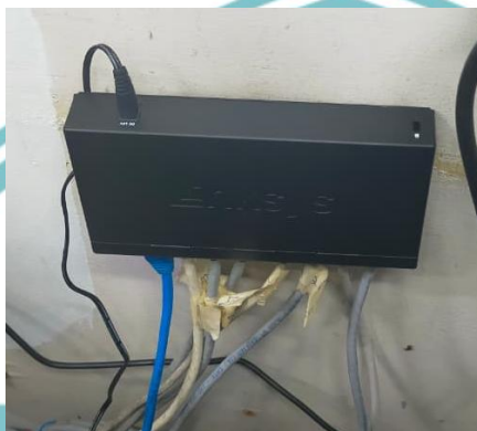
Gambar 4.28 Pemasangan Fisik Unmanaged Switch dan Jalur Kabel UTP Klien pada Dinding Ruang QC.
